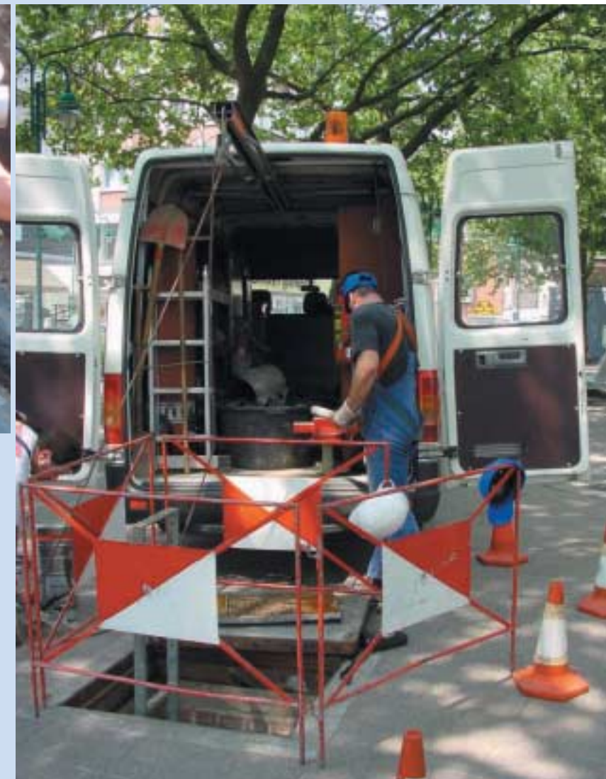
Das Befahren eines Fernwärmeschachtes im öffentlichen Verkehrsbereich erfordert neben den Sicherungen und Schutzvorrichtungen für die einfahrende Person auch eine ausreichende Absicherung der angrenzenden Verkehrsbereiche.
