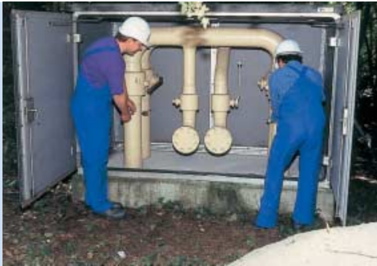
Vakuumisolierte Fernwärme-Rohrleitungen haben spezielle Kontrollstellen. Die notwendigen Armaturen sind in einer gut zugänglichen oberirdischen Schrankstation untergebracht.
