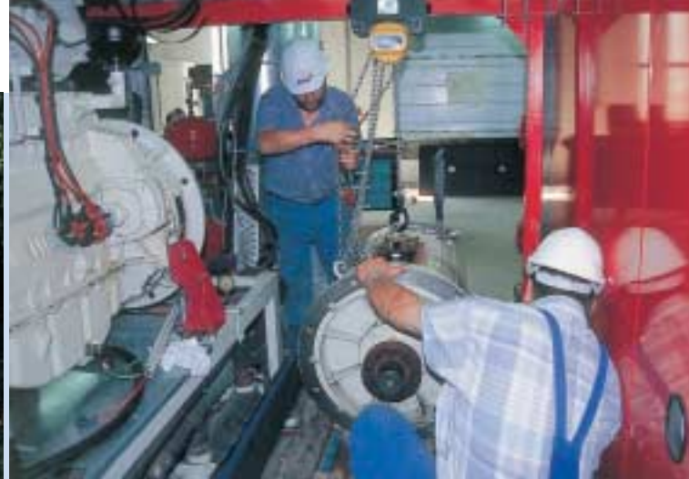
Arbeiten an einem Modul eines Blockheizkraftwerks. Schwere Lasten können mit einem mobilen Brückenkran sicher transportiert werden.
