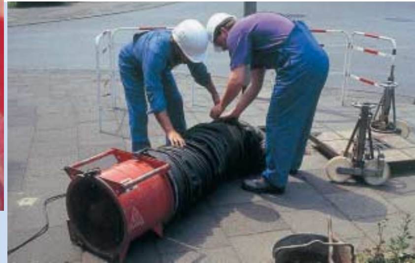
Um akzeptable Umgebungsbedingungen in einem Schachtbauwerk zu gewährleisten, wird Frischluft zugeführt. Die Schachttemperatur wird dadurch abgesenkt und die Personen im Schacht mit schadstofffreier Atmosphäre versorgt.
